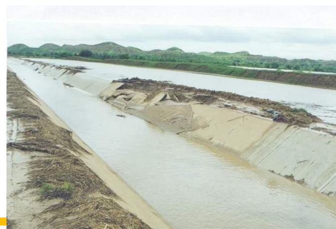
Canal Norte dañado
